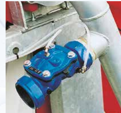
Válvula de descarga con accionamiento hidráulico asistido.
