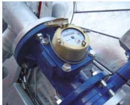
Compteur d'eau bridé sur entrée bobine.
