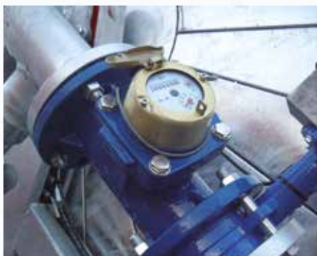
Cuentalitros bridado en entrada de la bobina.
