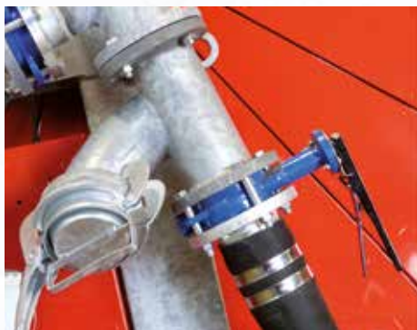
Conexión adicional para la entrada del purín y exclusión de la turbina.
