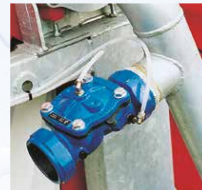
Válvula de descarga con accionamiento hidráulico asistido.
